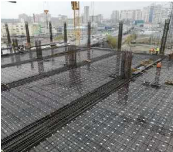
Рисунок 3. Монолітне перекриття з попередньо напруженими балками та плитами (Будівництво торгівельно-розважального комплексу в м. Києві)
