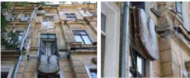
Рисунки 3, 4. Руйнування балкону в м. Одесі по вул. Базарній.
