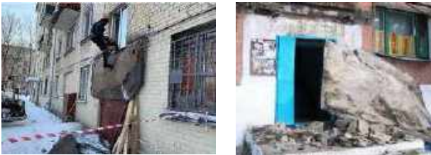
Рисунки 1, 2. Руйнування карнизної плити вхідної групи.
