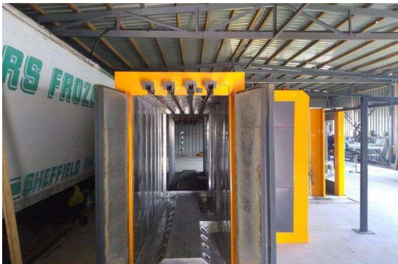
Рис 5.3 Загальний вигляд лінії фарбування
