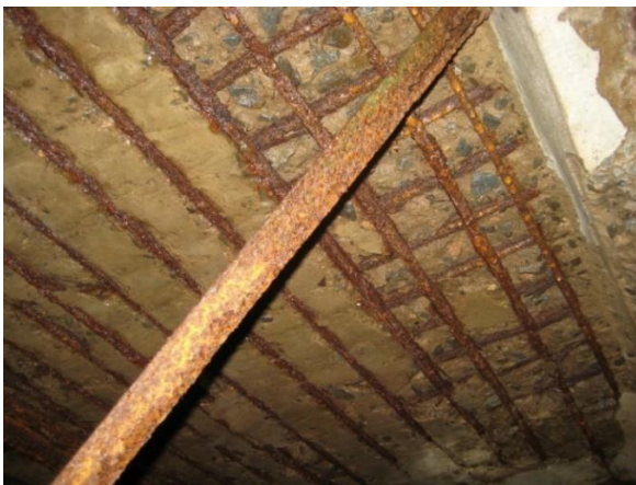
Рис. 1.8. Корозія бетону та арматури
