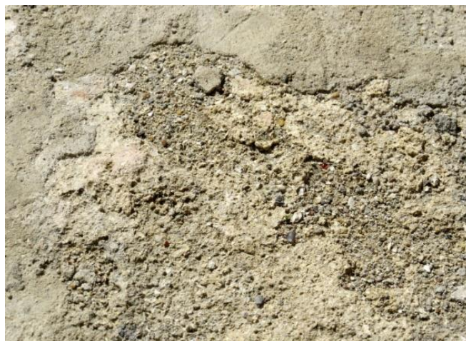
Рис. 1.12. Ерозія бетонної поверхні
