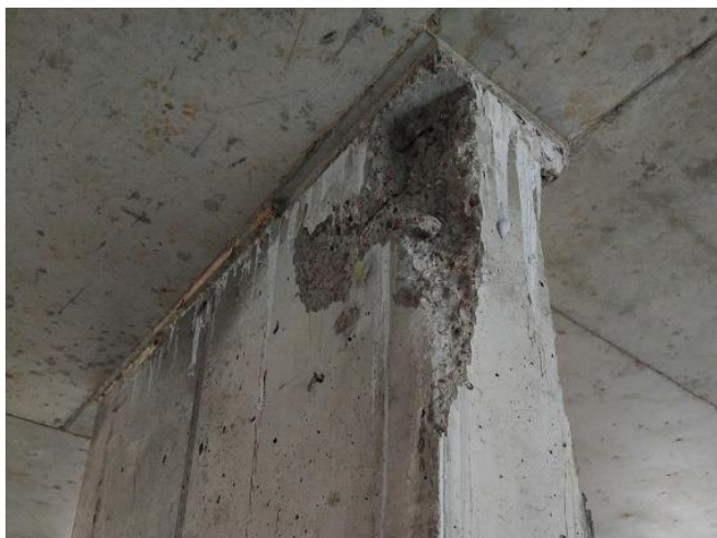
Рис. 1.11. Механічне пошкодження залізобетону від динамічних впливів
