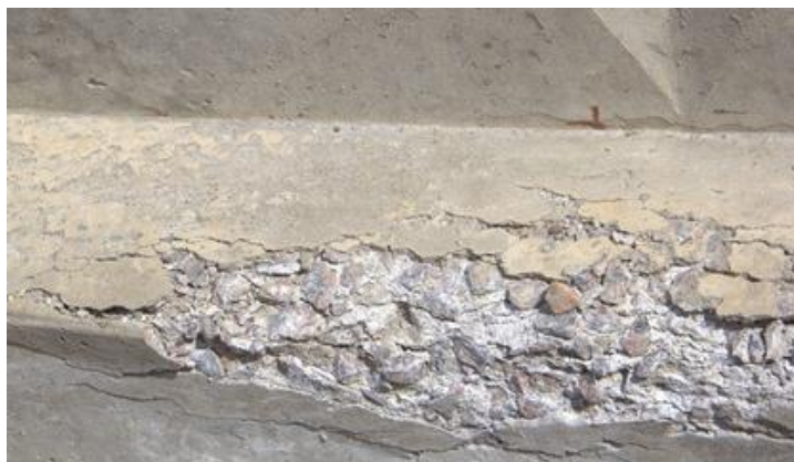
Рис. 1.10. Руйнування бетону внаслідок поперемінної дії низьких температур
