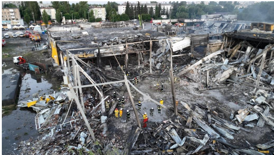
Рис. 1.12. Наслідок прогресуючого руйнування будівель від удару ракетою та пожежі по ТРЦ в Кременчузі
