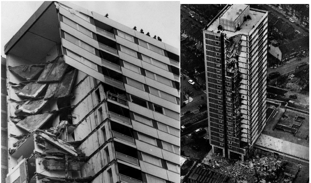
Рис. 1.1. Пошкодження житлового будинку «Ronan Point» 16 травня 1968р.
