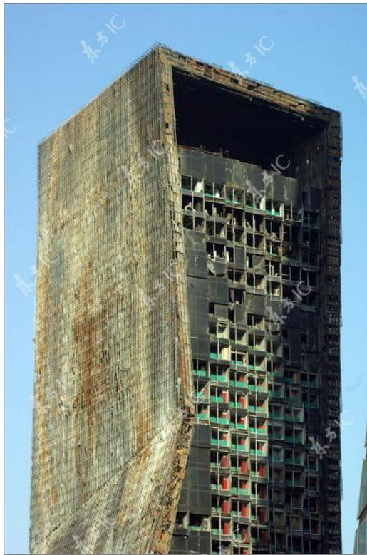
Рис 1.16. Наслідки руйнування будівлі зі сталевим каркасом від пожежі в Пекіні в 2009 р.
