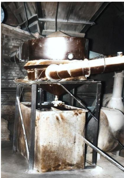
Рис. 4.9 Загальний вигляд компонування пиловловлювача циклонного типу з дисковим водорозпилювачем з внутрішньою циркуляцією очищеної води, в цеху Київського заводу скловиробів.
