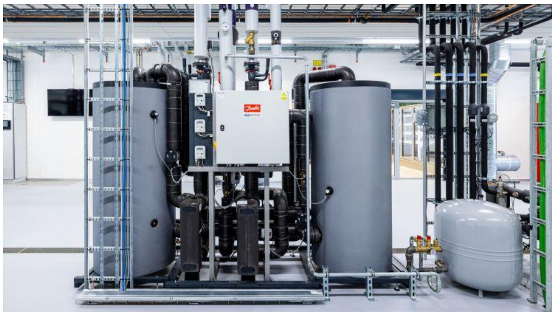
Рис.3.9 Модуль рекуперації тепла (Heat Recovery Unit) на базі Danfoss Smart Store підключений до системи охолодження CO 2 .
