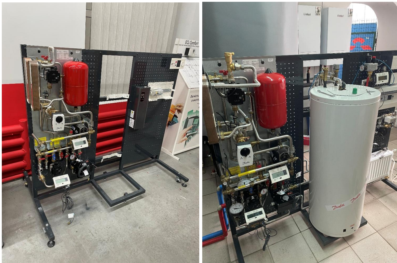
Рис.3.2 Експериментальний стенд 2Н-ІТП під час складання та (зліва) та при підключенні до системи тепlopостачання
