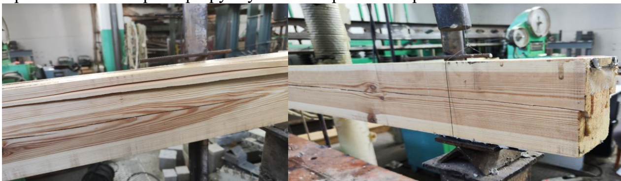
Рис. 20. Руйнування балок з цільної деревини SBR30(Prst) та SBR45(Prst) за рахунок сколювання
