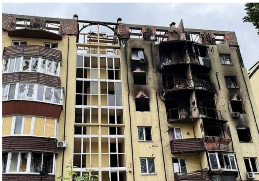
Рис. 1.4. Пошкоджена будівля, яка знаходиться в умовах ущільненої забудови [18]
