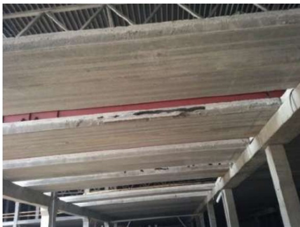
Рис. 1.2. Громадська будівля у м. Києві. Окремі ділянки змонтованих плит вирізані оскільки не відповідають проєктному значенню міцності
