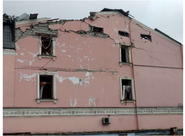
(2) Пошкодження фасаду готелю Брістоль
