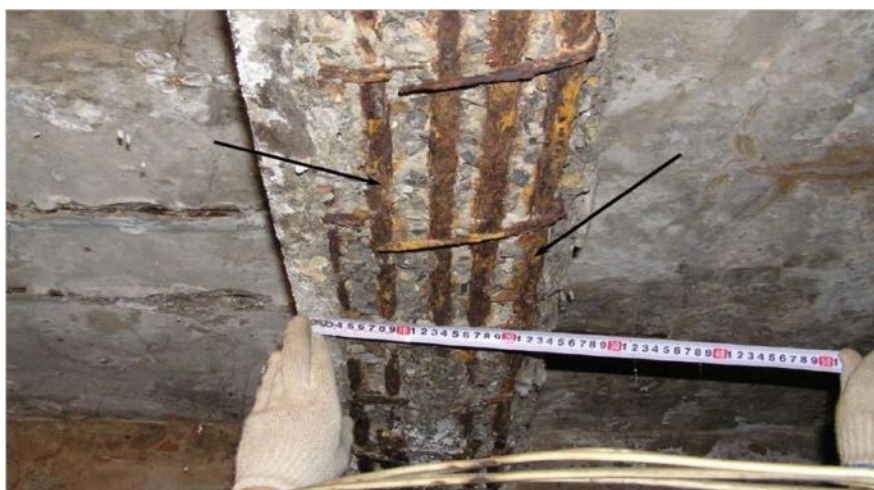
Рис. 4.7. Руйнування захисного шару бетону, оголення й корозія робочої арматури із втратою перетину до 30% балки перекриття в результаті тривалого впливу вологи. ВАТ ДМПЗ, м. Донецьк [56]
