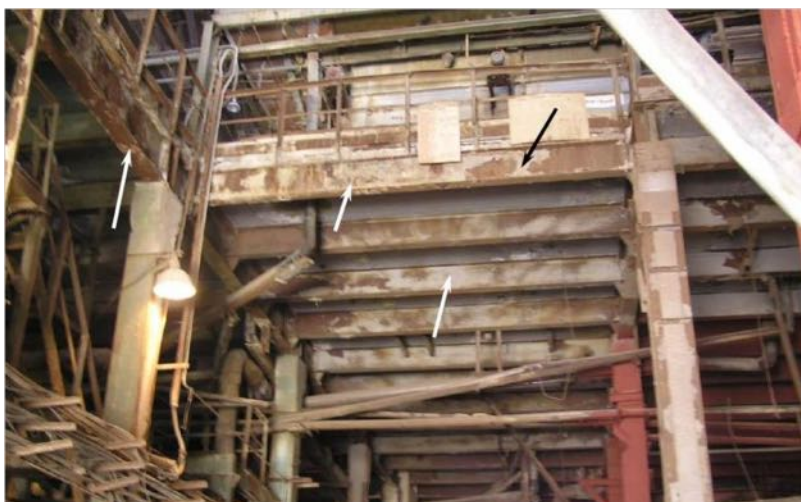
Рис. 4.6. Загальна поверхнева корозія металоконструкцій цеху з виробництва титанового порошку на АТЗТ «Титан» у м. Армянськ [56]
