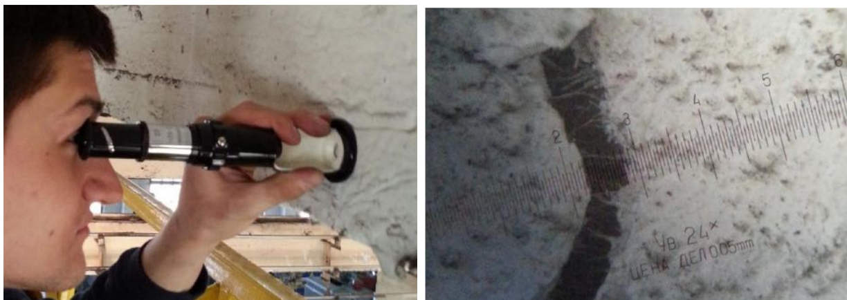
Рис. 3.8. Визначення ширини розкриття тріщини у балці покриття за допомогою мікроскопа МПБ-2 (Мир-2). ПАТ «Донбасенерго» [56]
