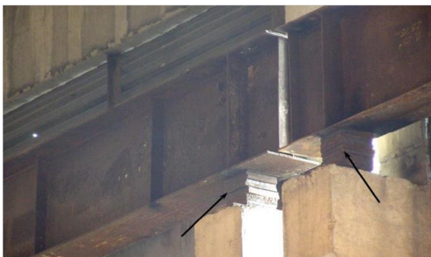
Рис. 4.4. Обпирання підкранових балок на консоль колони через багатошарові металеві підбивки не забезпечує надійного з'єднання. ТОВ «Електросталь», м. Курахово Донецької області [56]
