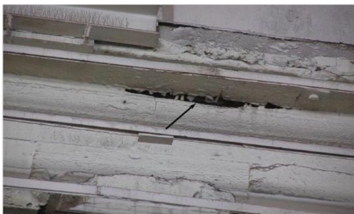
Рис. 4.1. Раковина у верхньому поясі монолітної залізобетонної підкранової балки внаслідок неякісного виконання бетонних робіт. ВАТ «Донецькгірмаш» [56]
