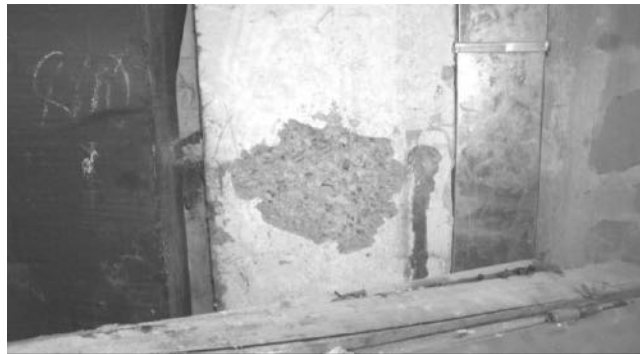
Рис. 3.10. Ямка у бетоні після визначення міцності бетону в колоні за допомогою приладу ГПНВ-5. ПУМА УГП Укрхімтрансміак, м. Горлівка
