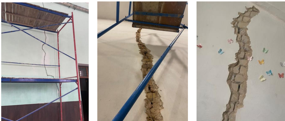
Рис. 4.9. Загальний вигляд типових тріщин (розщитих) внутрішніх стін, що підлягають ремонту
