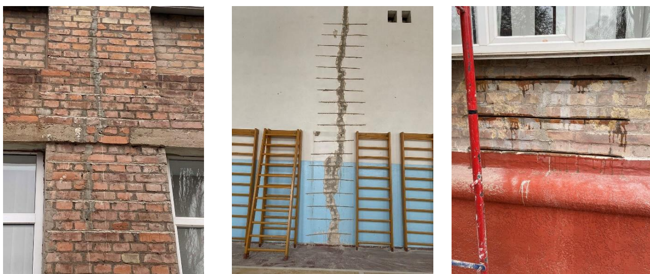
Рис. 4.15. Підсилення стінових конструкцій з тріщинами шляхом введення в них високоміцних елементів
