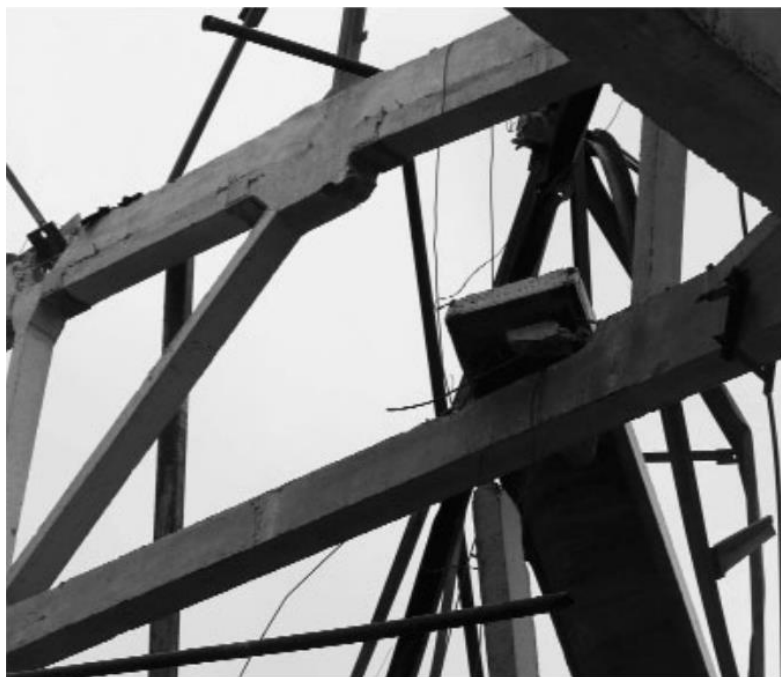
Рисунок 3.5. Приклад пошкодження 24-метрової залізобетонної ферми, яка зазнала втрати елемента після обстрілу
